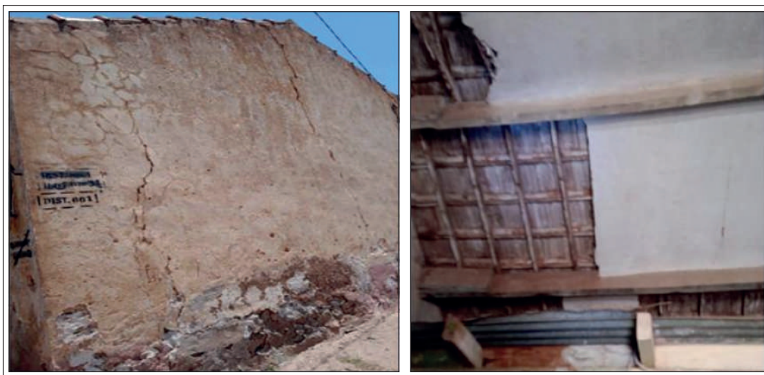
Fig. 2 - Photographies montrant l'effet du séisme (choc principal) sur certaines bâtisses anciennes dans la ville d'Arzew. Il s'agit de fissures dans les murs en maçonnerie ancienne (photographie à gauche) et de chutes des faux plafonds (photographie à droite).
