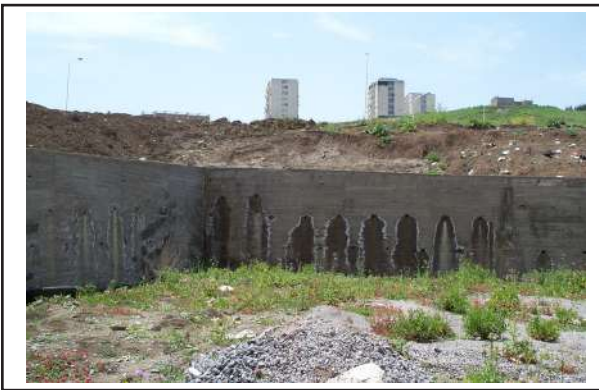
Photo 9 - Ecoulement d'eau souterraine dans des barbacanes sur un mur de soutènement.
