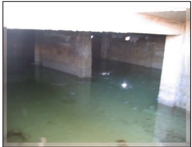
Photo 10 - Sous-sol de bâtiment constamment inondé, baignant dans la nappe superficielle des argiles décomprimées miocènes
