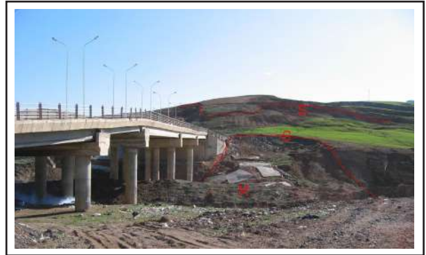
Photo 15 - Séries de glissements récents sur le versant rive droite de l'oued Rhummel (lieu-dit Massinissa) entraînant la dégradation de la culée du pont.
