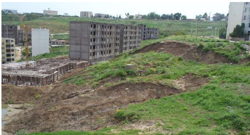
Photo 2 - Vue de la partie basse du site Boussouf (2005). Les bâtiments en construction (B) sont sur un glissement de terrain actif.
