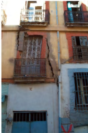
Photo 6 - Bâtiment R+3, en maçonnerie, très endommagé, quartier Bélouizdad.
