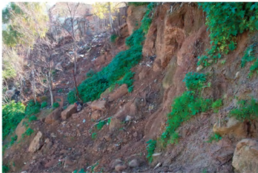
Photo 5 - Ecoulement de la falaise la plus basse, suivant des fractures verticales, orientées est-ouest.
