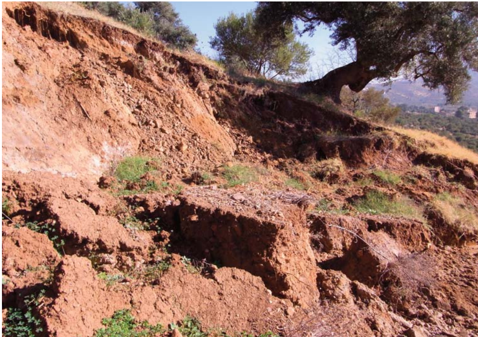
Fig. 5 - Conséquence de la rupture des sols en amont du glissement, inclinaison des arbres et arrachements dans la zone instable
