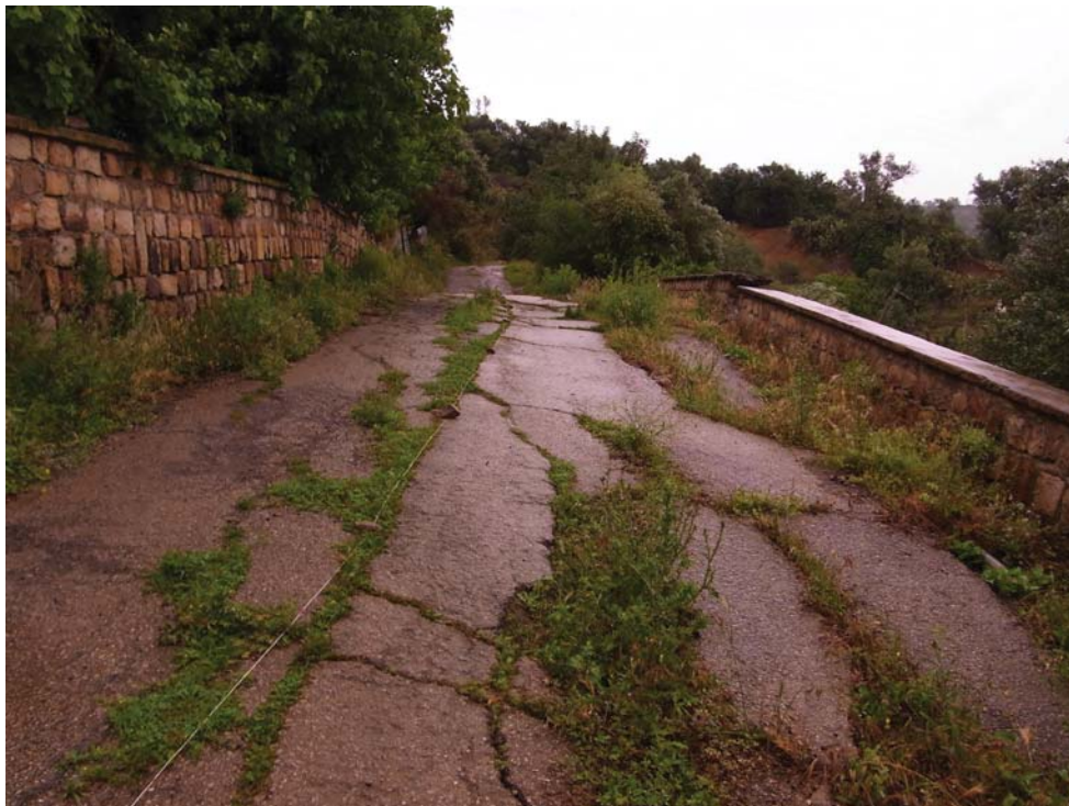
Fig. 6 - Déformation des sols colluvionnaires sur le bourrelet du glissement
